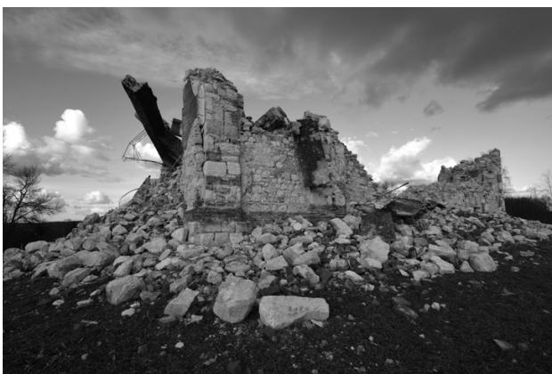
Sl. 14. Crkva svetog Stefana u Donjoj Bačugi nakon urušavanja u potresu od 29. 12. 2021. (foto: D. Damjanović, 4. II. 2021.)
